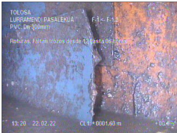
Fotografía: 12_2a 1,6m, Roturas. Faltan trozos desde 12 hasta 06 horas
